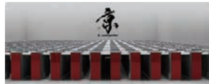
図1 「京」コンピュータの外観
